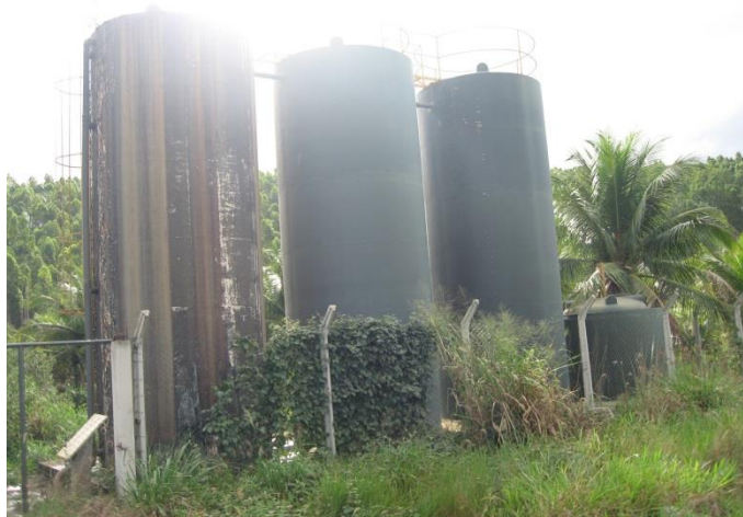
Figura 30 - Estação de Tratamento de Esgoto de São Jorge de Tiradentes
