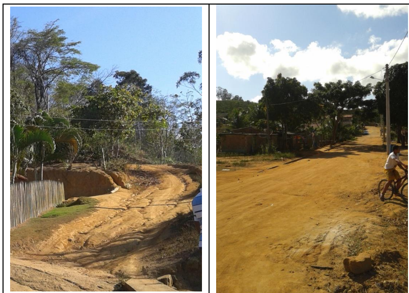
Figura 85 - Erosão das vias não pavimentadas
