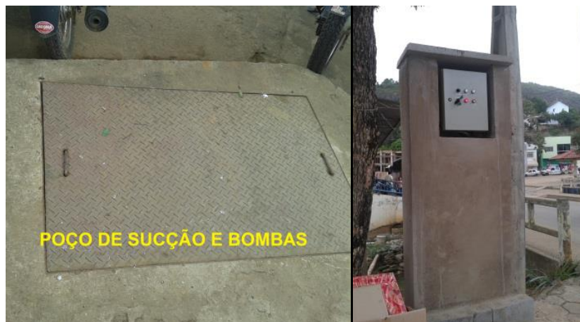
Figura 26 - Estação Elevatória de Esgoto 02 - Próxima a praça Vitório Bachette
