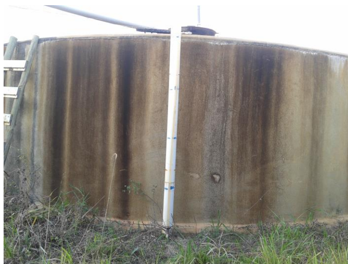
Figura 28 - Reservatório de água tratada de São Jorge de Tiradentes
