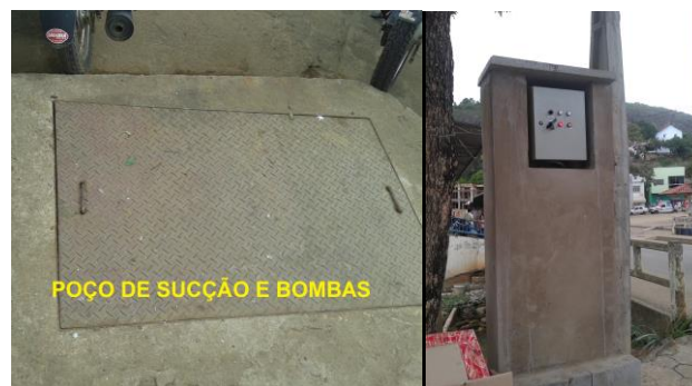
Figura 35 - Estação Elevatória de Esgoto 02 - Próxima a praça Vitório Bachelette
