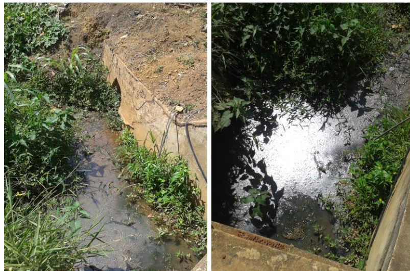
Figura 42 - Lançamento de esgoto próximo a entrada do povoado de Santo Izidóro de Tiradentes
