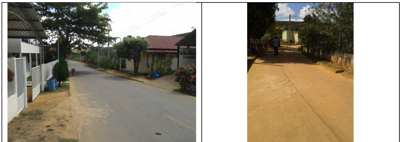
Figura 51 - Aspectos das vias e falta de infraestrutura de microdrenagem.
