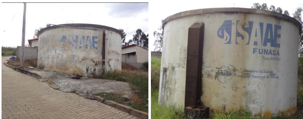
Figura 8 - Reservatórios de água tratada de Rio Bananal
