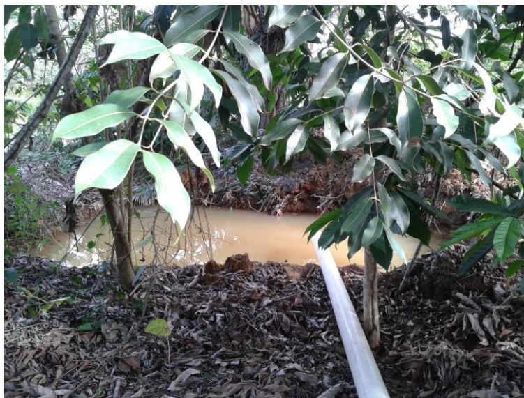
Figura 26 - Tanque de filtragem do efluente de lavagem de filtro e decantador
