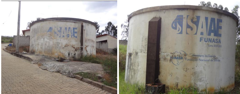
Figura 23 - Reservatórios de água tratada de Rio Bananal
