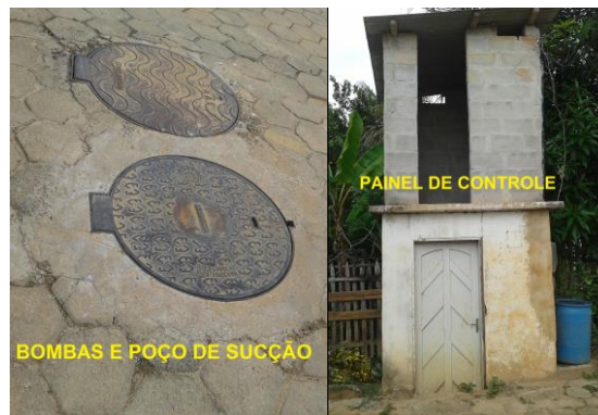
Figura 34 - Estação Elevatória de Esgoto 01 - bairro São Sebastião
