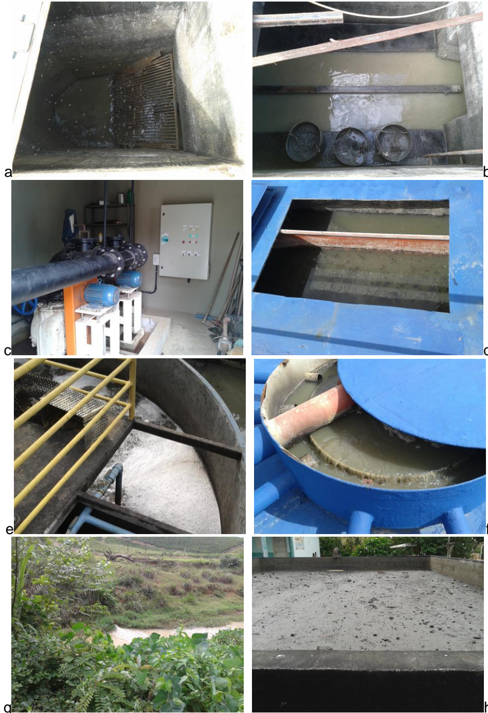
Figura 36 - Estação de Tratamento de Esgoto de Rio Bananal
