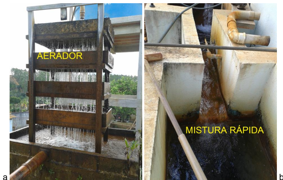
Figura 25 - Estação de Tratamento de Água de São Jorge de Tiradentes
