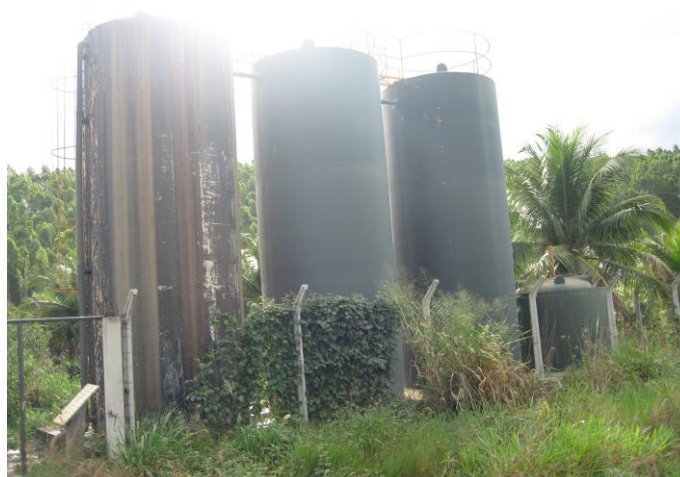
Figura 39 - Estação de Tratamento de Esgoto de São Jorge de Tiradentes
