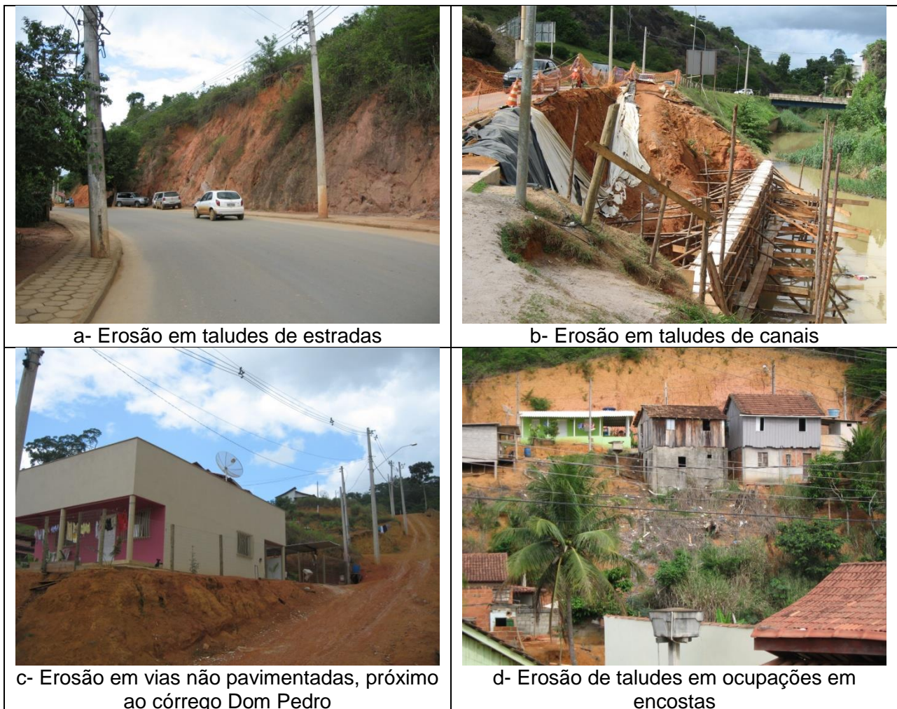
Figura 79 - Erosões na sede do município de Rio Bananal
