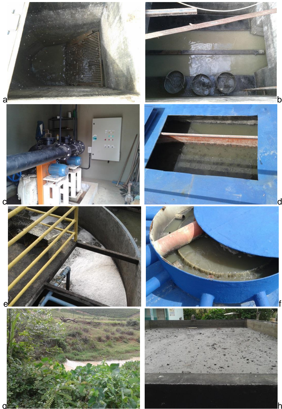
Figura 27 - Estação de Tratamento de Esgoto de Rio Bananal
